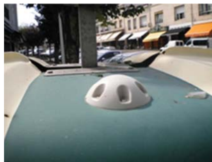
Système SYREN sur colonne aérienne
