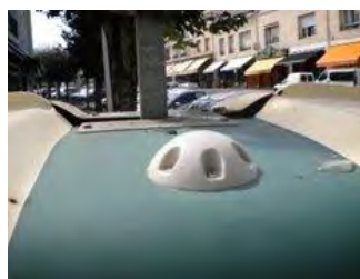
Système SYREN sur colonne aérienne
