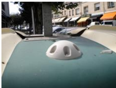
Système SYREN sur colonne aérienne
