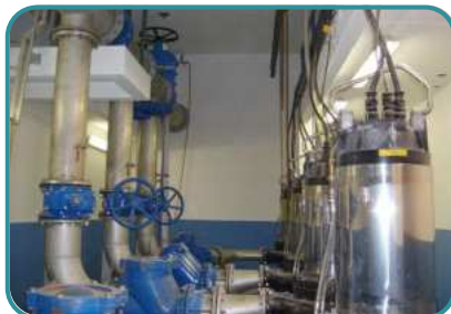
Postes de refoulement du « Rhâ » à Saint-Palais-sur-Mer.
