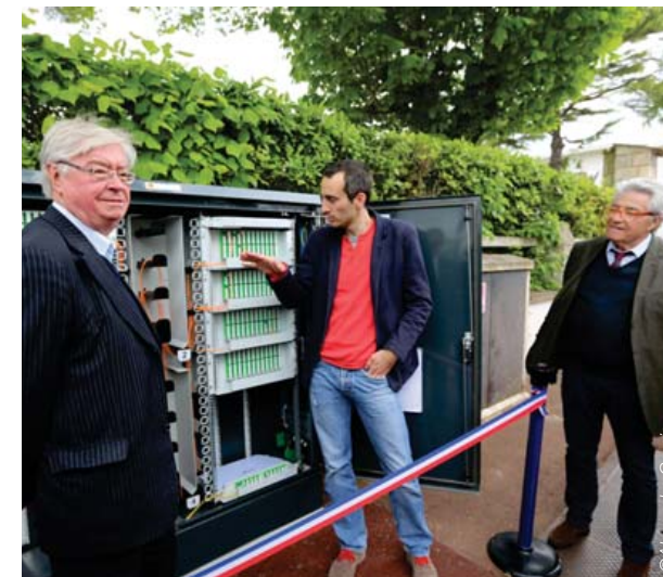
Deux premières armoires de raccordement à la fibre optique ont été inaugurées le 5 mai à Royan. Trois phases d'aménagement sont prévues dans la ville, au cours desquelles Orange prévoit d'équiper environ 19 000 logements jusqu'en 2022.
