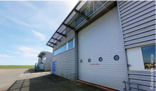
Les ateliers relais de Cozes, de La Tremblade et le centre technique de Saint-Sulpice-de-Royan seront équipés de panneaux photovoltaïques.
